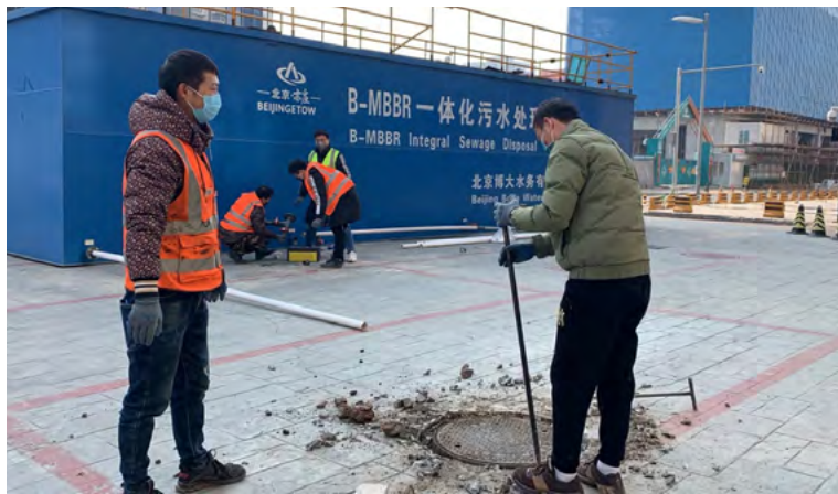
亦庄水务在医学留观区安装自主研发的MBR、B-MBBR一体化污水处理专利设备，这种设备能够对多种污水水质进行深度处理，有效消灭病菌
