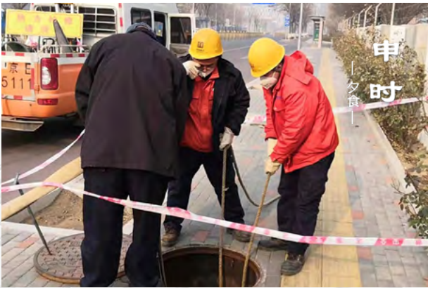
开拓热力确保防控措施全覆盖、无死角，抗击疫情，保障供热。在疫情面前，太多的热力人放弃了假期，在做好防护措施的同时值守在工作岗位，守护着千家万户的温暖，践行着“温暖千家万户，助力美好生活”的庄严使命。
